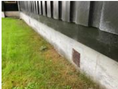
Magert behandlet mur, rust på ventilklafter.
