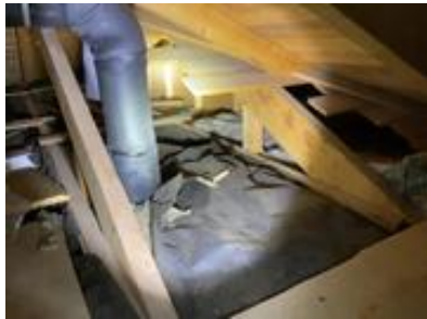
Isolasjon eller vindtetting mot kald side som mangler.
