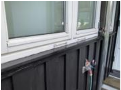
Vinduer på værutsatte sider med slitassjer/avflassing.
