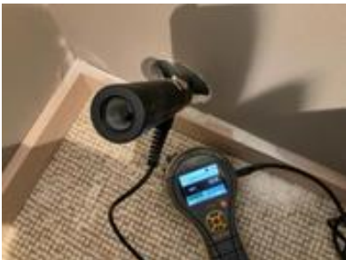
Fuktsøkt i påforet yttervegg i kjellerstue.
