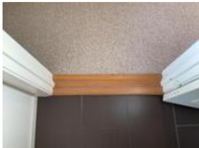
Tepper og fliser i underetasje.
