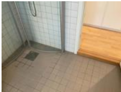
Dør plassert i dusjens fuktsone.
