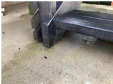
Trapp/vanger står direkte ned på underlaget/betong.
