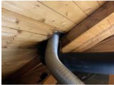
Uisolert rørgjennomføring i tak med fuktmerker rundt.
