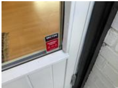
Enkelte værslitassjer på balkong/ytterdører.
