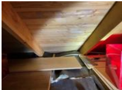
Merker i undertak/rupanel etter kondensering, ingen lufting fra raft.
