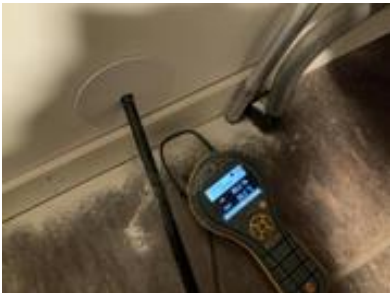
Fuktsøkt i påforet yttervegg i bod.
