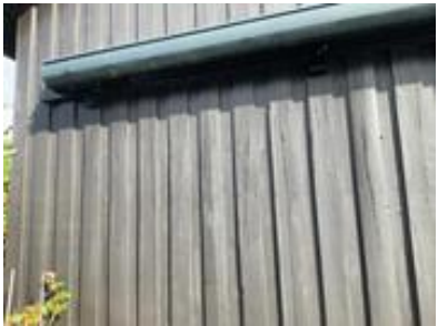
Sprikker i bordkledning, her mot sør.
