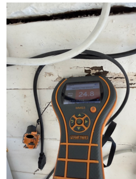
Utslag på fuktmåling på loftet.
