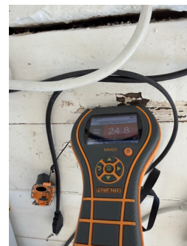
Utslag på fuktmåling på loftet.
