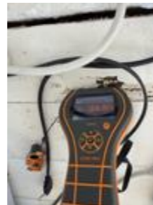
Utslag på fuktmåling på loftet.
