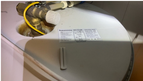
Varmtvannsbereder plassert i vaskerom.
