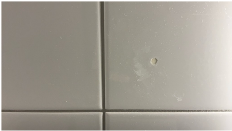
Hull i flis etter tidligere installasjoner.
