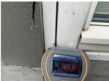
Høyt fuktnivå vindu
