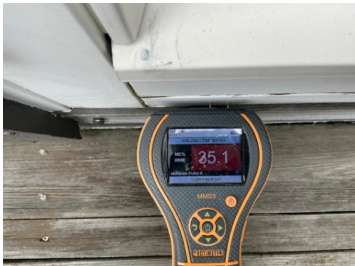
Høyt fuktnivå i terrassedør
