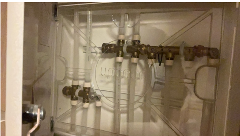
Rør i rør med kursfortegnelse.
