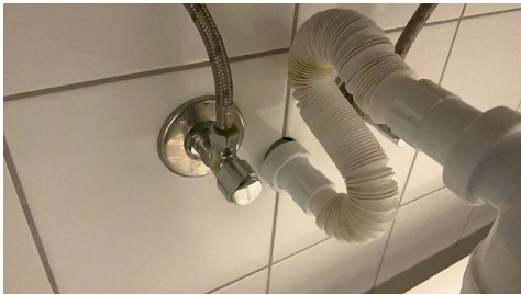
Manglende tetting rundt avløp under vask.
