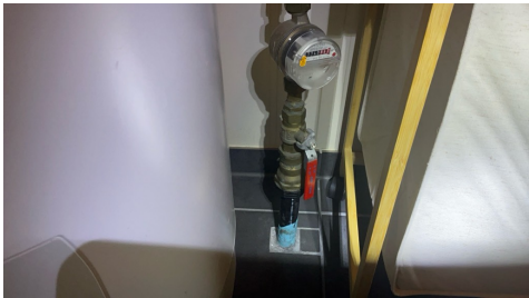
Hovedstoppekran i vaskerom.
