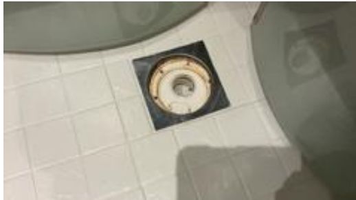
Plastsluk i gulv i dusjsone
