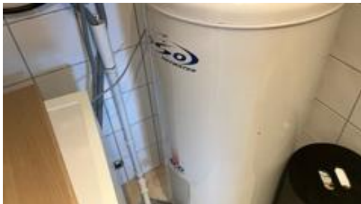
Bereder plassert på vaskerom.
