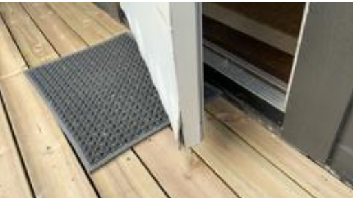
Svelleskade på hovedytterdør må repareres eller alternativt skifte ut dør.
