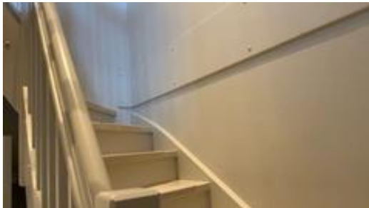
Håndløper på vegg er ikke montert i trappeløp.
