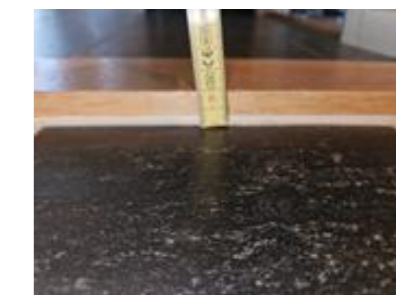
Det er etablert en oppkant under dørstokken som ekstra sikring mot lekkasje
