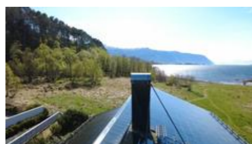
Pipetrek av metall. Stigetrinn og plattform for feier
