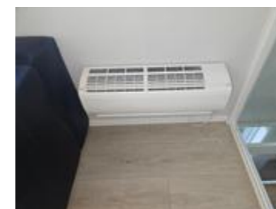
Luft til luft varmepumpe
