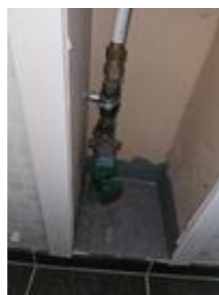
Stoppekran og reduksjonsventil for vann. Denne kranen stengte ikke vannet ved befarig.
