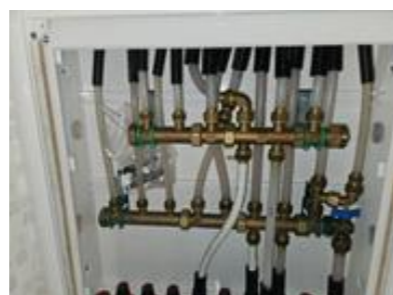
Fordelingsskap for tappevann med stoppekran
