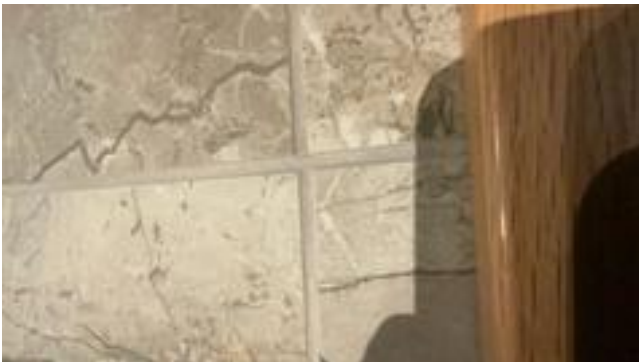
Ut mot døren inn til badet er det registrert riss i flisfuge.
