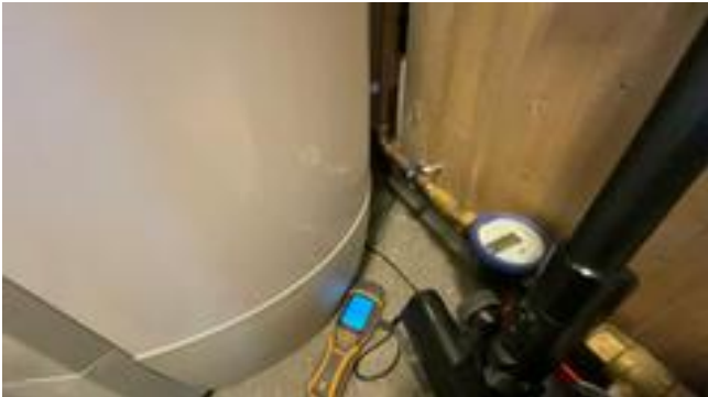
Fuktmåling er foretatt bak varmtvannsbereder.
