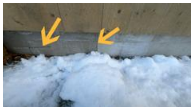
Ikke tett mellom elementene og det er en skade.
