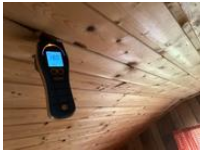
Bilde av synlige fuktmerker og fuktsøk som viser forhøyede fuktverdier.
