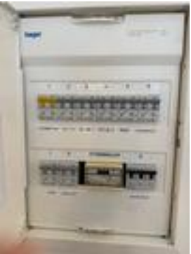
Automatsikringer med skap i hybel.
