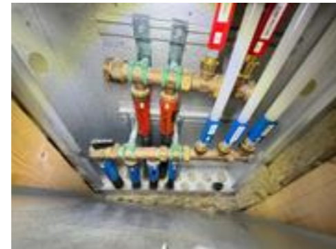
Rørskap i hybel
