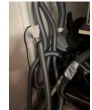
Sentralstøvsuger i bod, Uetg
