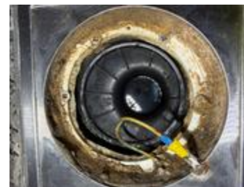
Sluk i dusjsone.
