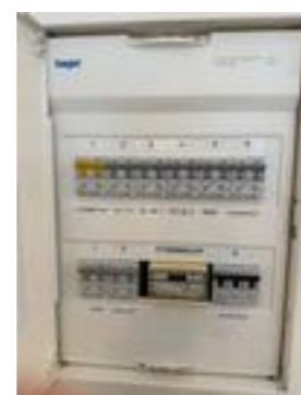
Automatsikringer med skap i hybel.
