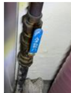
Hovedstoppekran på teknisk rom.
