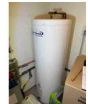
Ny 300 liters bereder fra 2026, montert etter bilde ble tatt
