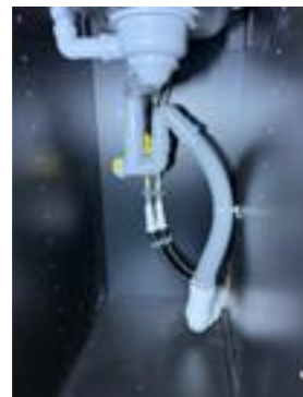
Røropplegg i kjøkkenbenk, hybel
