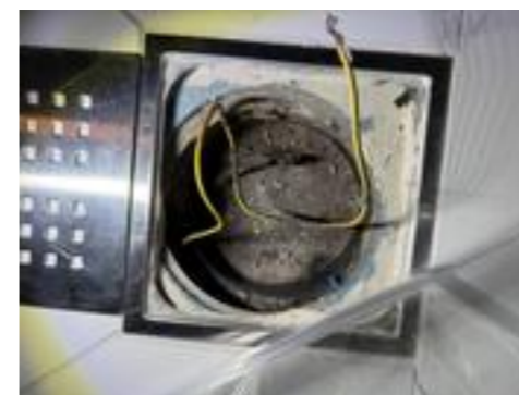
Sluk i dusjsone.
