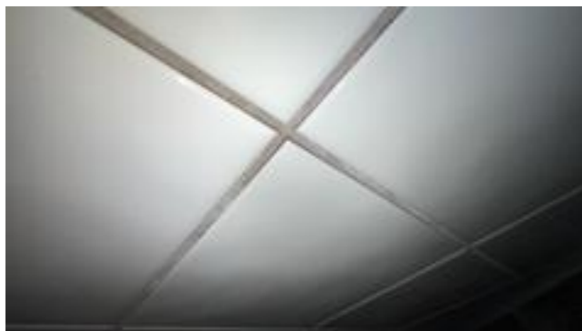
Grunne og slitte fuger.
