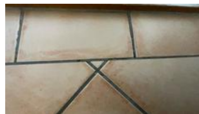
Det er slitte, oppsprukne og grunne fuger.
