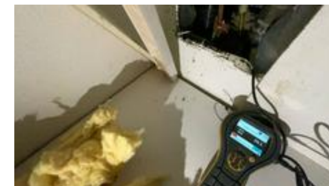
20. mars: Fuktmåling i svill mot sør viser at det er meget fuktig.
