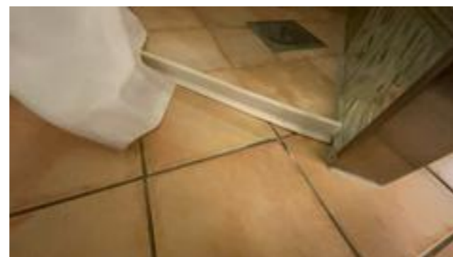
Det er tett terskel inn til sluk i dusjsonen.
