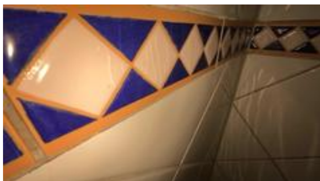
Flisene har krakelering.
