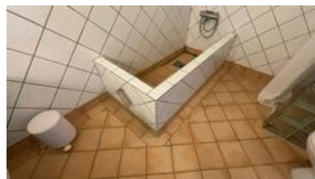
Det er tett inn til sluken under badekar.
