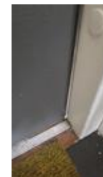
Åpning mellom dørbblad og karm.
