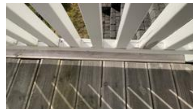
Rekkverket er noe værslitt og oppsprukket.
