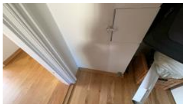
Det mangler ildfast plate mot gulvet.
