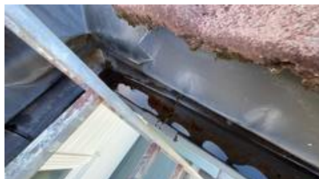
Takrennen har motfall og det fører til at det står vann i takrennen.
