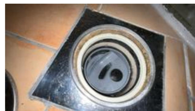
Sluk i dusjsone.
