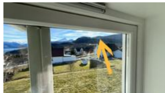
Det er noen små merker i glassene på vinduene i stuen.
