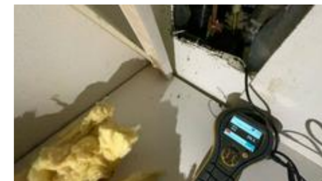
20. mars: Fuktmåling i svill mot sør viser at det er meget fuktig.
