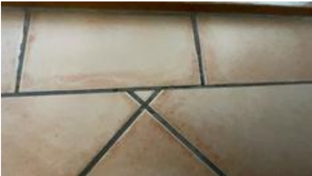
Det er slitte, oppsprukne og grunne fuger.
