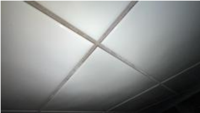
Grunne og slitte fuger.
