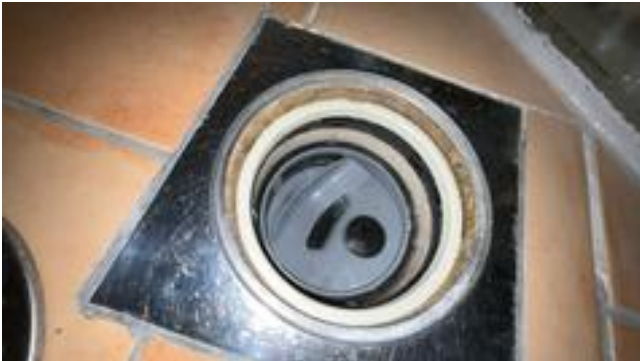
Sluk i dusjsone.
