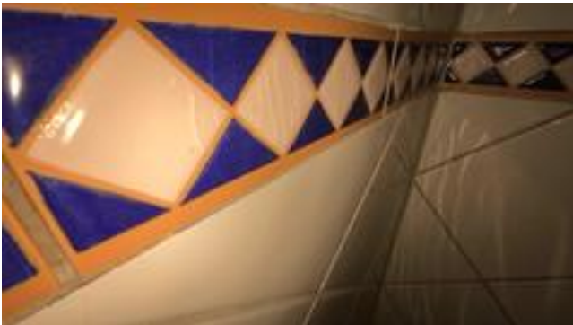
Flisene har krakelering.
