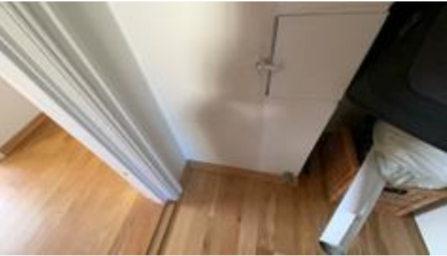
Det mangler ildfast plate mot gulvet.
