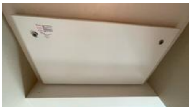
Ventilasjon henger i taket.
