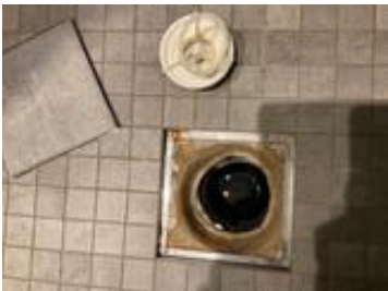
Sluket i dusjsonen-Synlig banemembran
