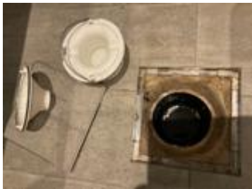
Sluket ved toalettet-Synlig banemembran
