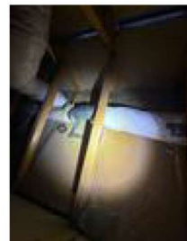
Tidligere uttett kanal, kan være årsaken til misfargingen.
