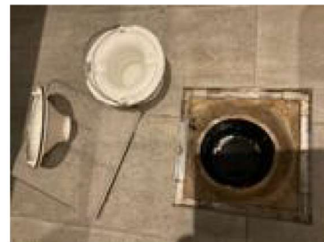
Sluket ved toalettet-Synlig banemembran
