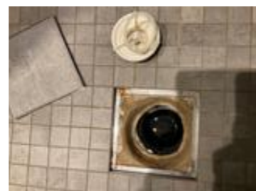
Sluket i dusjsonen-Synlig banemembran
