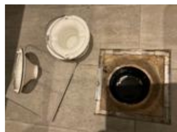
Sluket ved toalettet-Synlig banemembran
