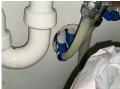
Mangler tettemuffe på kjøkken.
