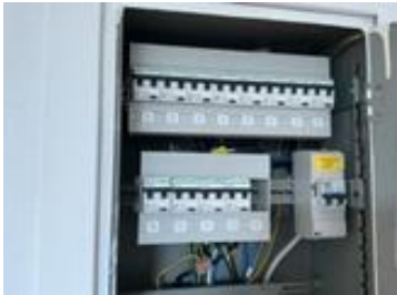
Sikringsskap med automatsikringer.
