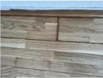
Oppsprekking i parkett.
