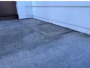
Liten avstand mellom platting og kledning.
