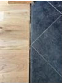
Manglende avslutning mellom fliser og parkett.
