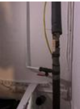
Stoppekran i kott under trappa.
