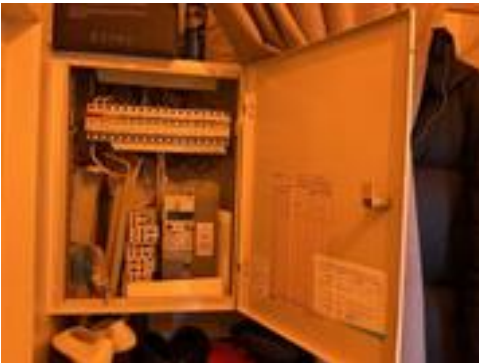
Sikringsskap med automatsikringer og kursfortegnelse
