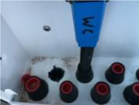
Dreneringsåpning i bunnen av fordelingsskapet
