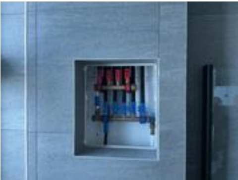
Fordelingsskap for tappevann. Med stoppekran
