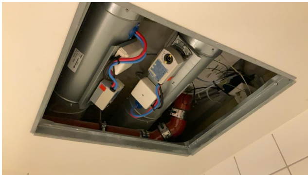
Diverse ventilasjonsrør/styringer i tak på bad.
