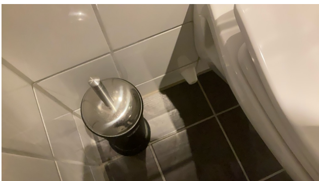
Drensåpning fra toalett-kasse.
