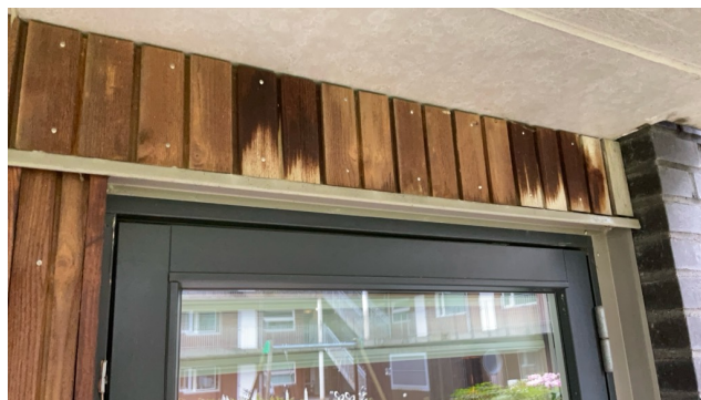
Dørblad seget ned, skjev åpning opppe.
