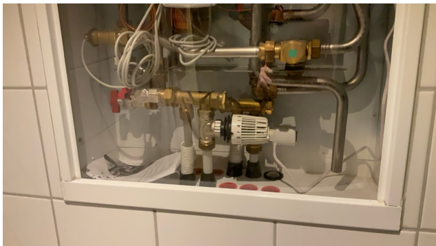
Regulatorer/motorer på vannbåren varme.
