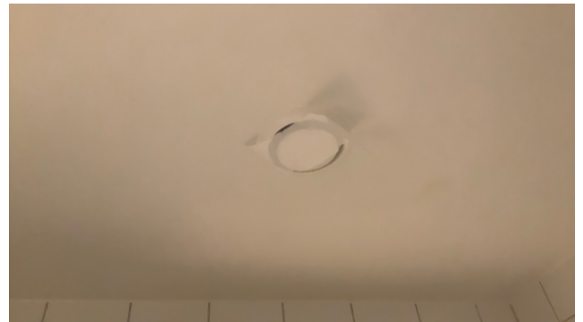
Avtrekk funksjonstestet med papir.
