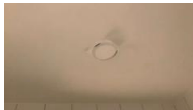
Avtrekk funksjonstestet med papir.
