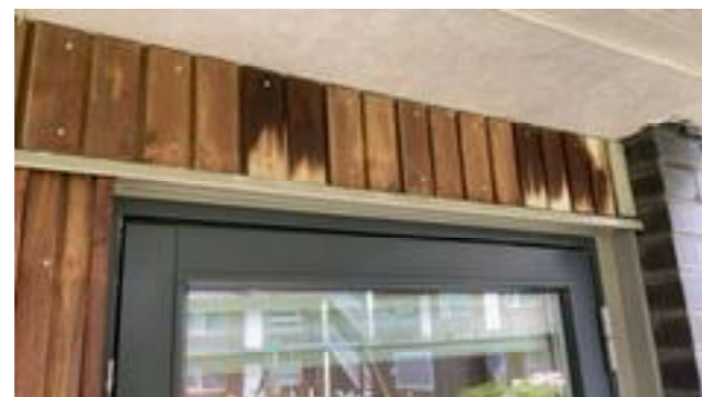
Dørbled seget ned, skjev åpning oppe.
