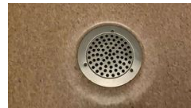
Sluk i gulv.
