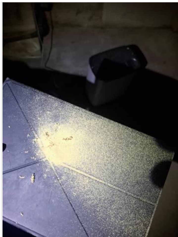
Mye gult boremel fra bordet i taket som bar spist opp innvendig.
