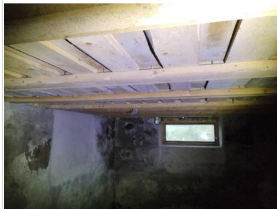
I kjeller delen bygd på 60-tallet mpler det ved fuktighet opp mot 11%
