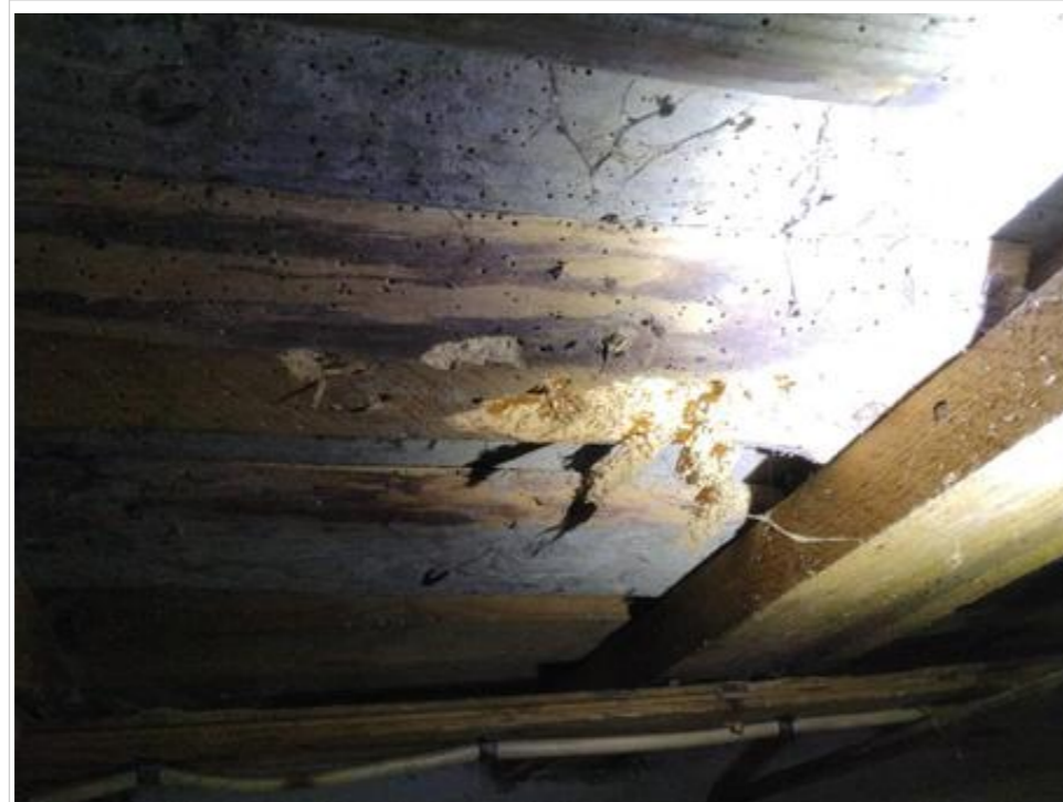
Ett bord i Kjeller er helt spist opp innvendig. Det kommer mye gult boremel npr en pirket på bordet.
