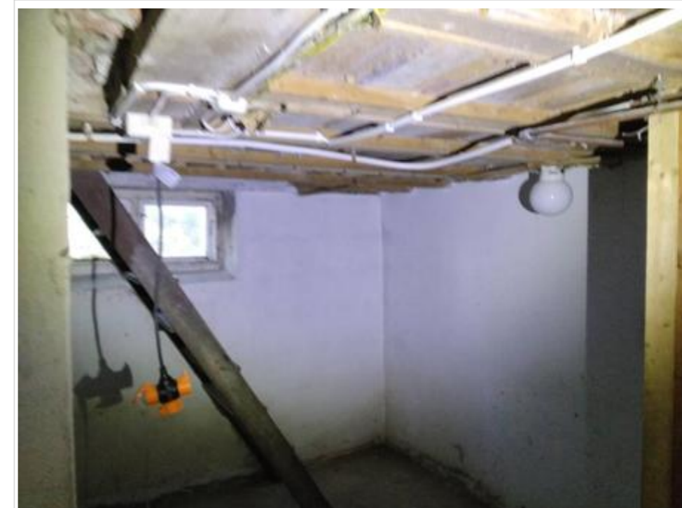
I kjeller deen på orginal delen bygget pp 50-tallet måles det rundt 10% ved fuktighet
