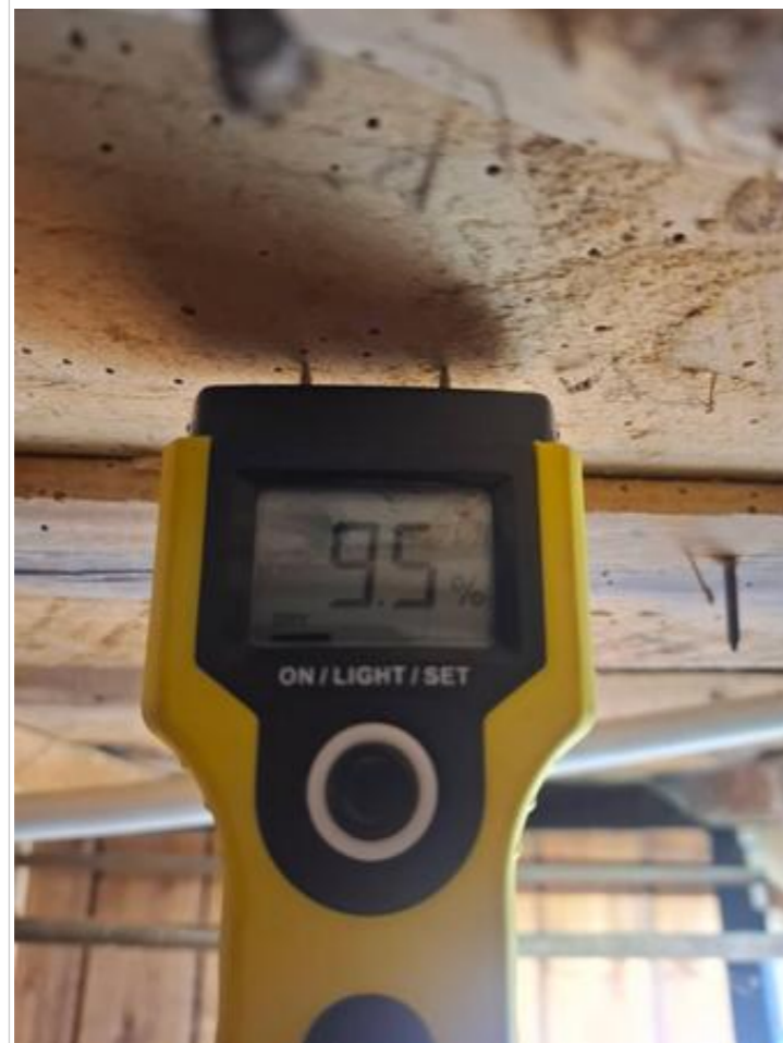
9,5% ved fuktighet i den eldste delen av kjelleren
