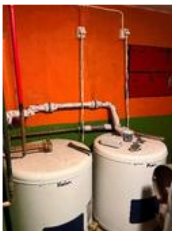
Varmtvannsberederne er plassert i kjelleren.
