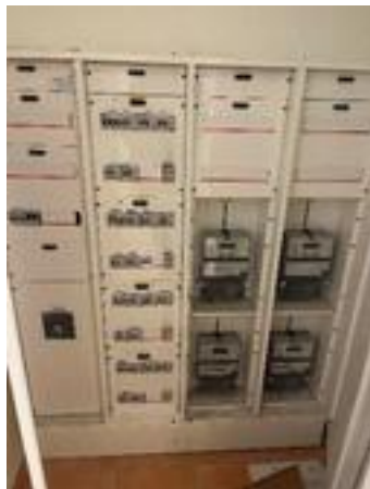
Felles tavle for kurser og målere i entré i nyere del.
