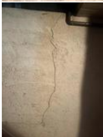
Eksempel på sprekke i grunnmur.
