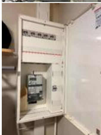
Sikringskapet til H0103.
