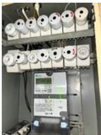
Sikringskapet i H0104.
