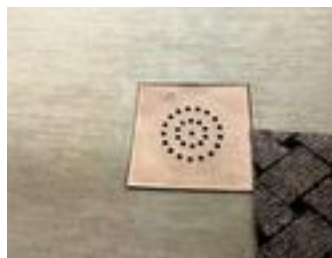
Eldre belegg som ikke er klemt i sluket.
