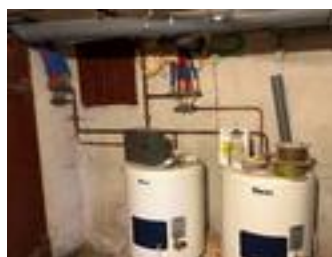
Varmtvannsberederne er plassert i kjelleren.
