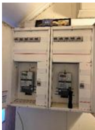
Sikringskap til leilighetene i andre etasje i eldre del.
