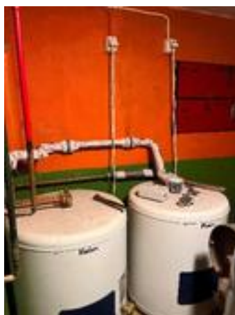
Varmtvannsberederne er plassert i kjelleren.
