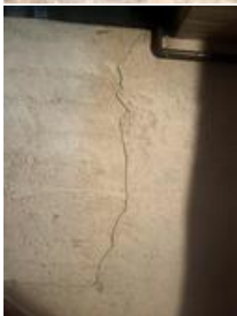
Eksempel på sprekk i grunnmur.
