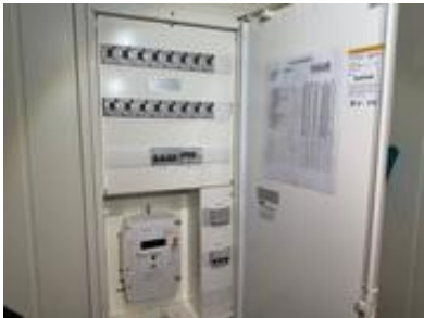
Bilde viser sikringsskap for det elektriske anlegget.
