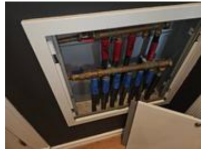
Fordelingskap for tappevann
