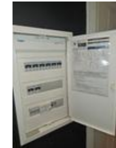
Sikringskap med automatsikringer og kursfortegnelse
