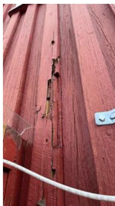
Eksempelbilde av råteskadet kledning.
