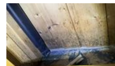
Fuktmerker/ svertesopp i panel på vaskerom.
