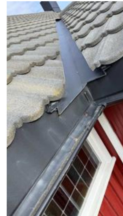
Eksempelbilde av rust på beslag og renner.
