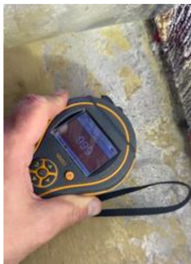
Eksempelbilde av forhøyede fuktverdier ved fuktsøk.
