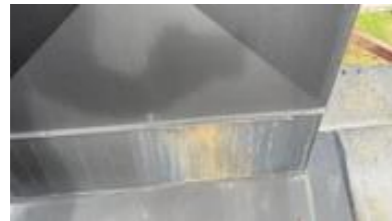
Eksempelbilde av rust på beslag til skorstein.
