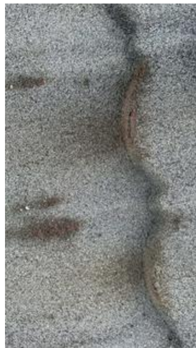
Eksempelbilde av rust på takplater.
