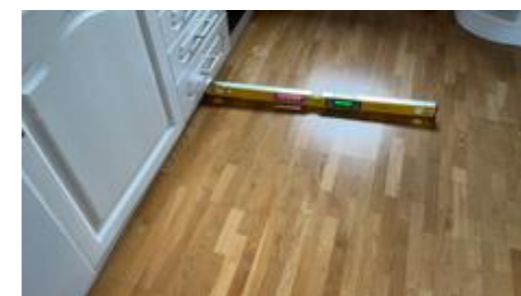
Nedbøyning går inn under innredningen.
