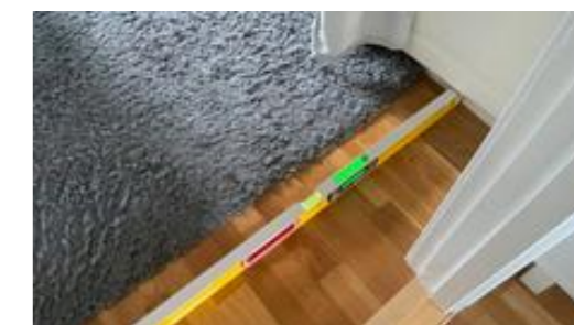
Skjevhet er også registrert i tilstøtende soverom og retningsavvik på 9mm/meter er registrert her, i retning fra døråpning og mot vegg som vender mot kjøkken.
