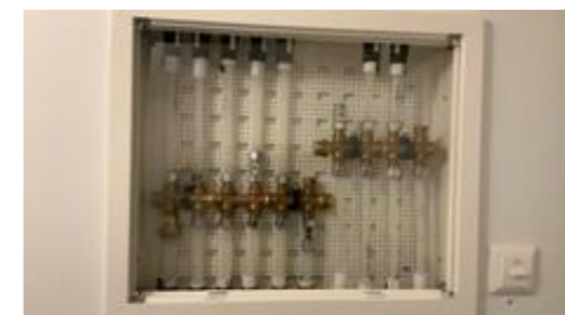
Vannfordelingskap plassert på vaskerom
