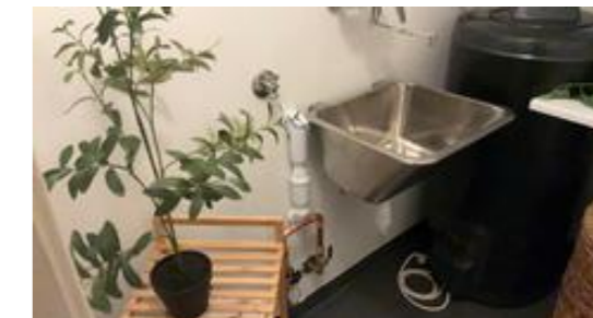
Ny hovedstoppekran på vaskerom
