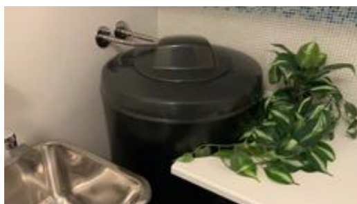
Ny Høiax bereder plassert på vaskerom.
