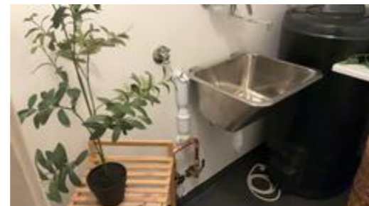
Vegg mellom bad og vaskerom er oppusset nylig og rommet har ikke vært i bruk etter oppussing.
