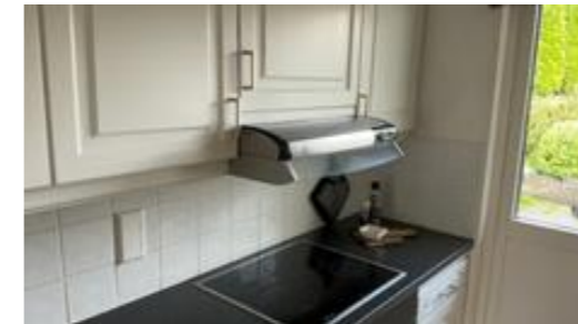
Avtrekksventilator på kjøkken
