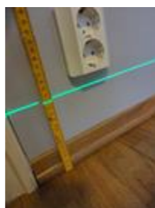
Høydeforskjell gulv soverom gjennom hele rommet.
