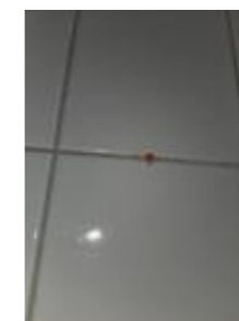
Hull etter eldre oppheng i dusjsone.
