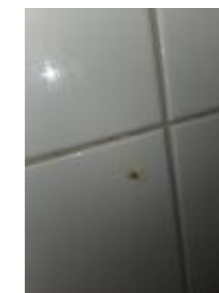
Hull etter tidligere dusjvegg.
