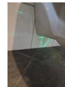
Mangler hull for synliggjøring ved lekkasje.
