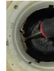
Konstatert membran under klemring ETASJE > BAD
