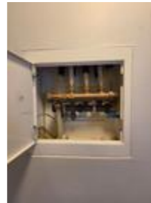
Manglende merking av fordelingskap.
