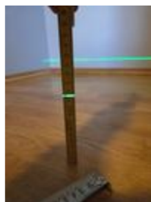
Høydeforskjell gulv soverom gjennom hele rommet.
