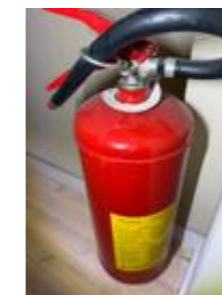
Datert 2016, 6 kg brannslukker
