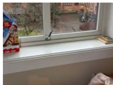
Tregthet i lukking av et vindu
