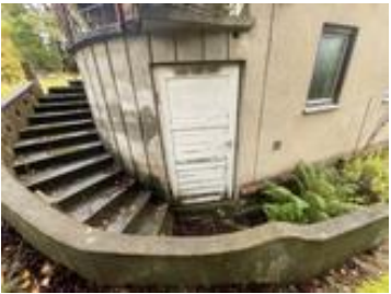
Dør med råteskader
