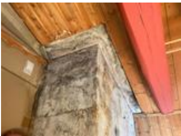
Fuktskjolder i pipegjennomføringen
