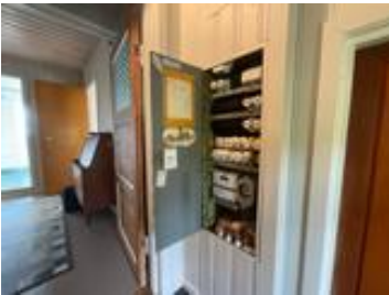
Sikringsskapet i 1.etasje
