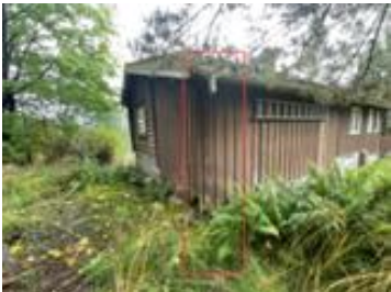
Bortledning av vann mangelfull
