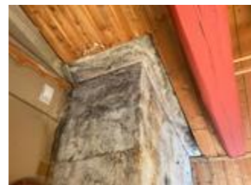
Fuktskjolder i pipegjennomføringen
