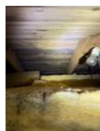
Misfarging undertak på deler av konstruksjonen synlig fra loftsluken
