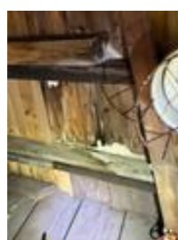
Observasjoner av det som kan være sopp i konstruksjonen i uteboden.
