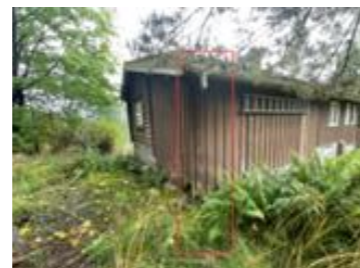
Bortledning av vann mangelfull
