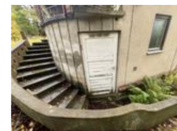
Dør med råteskader
