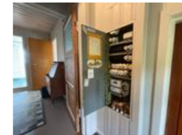
Sikringskapet i 1. etasje
