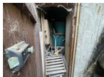
Kryp kjeller fylt ut til døren. Adkomst umulig
