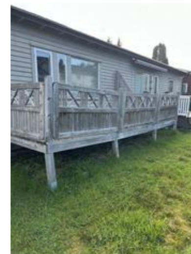
Terrasse med både retningsavvik og råteskader.
