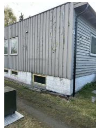
Råteskader og slitt overflate på kledning.
