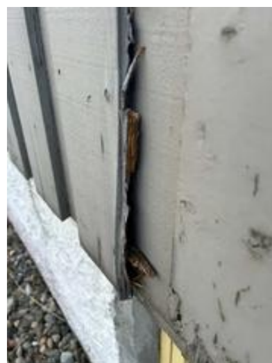
Råteskader i kledning.
