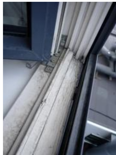
Noe slitasje på vinduskarm.
