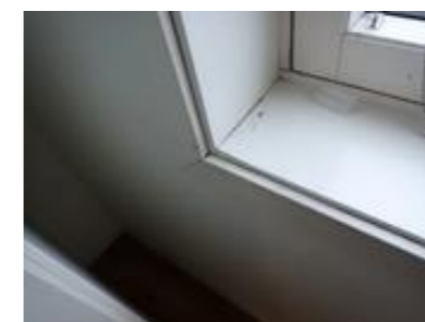
Svelling/fuktskade i venstre hjørne på karmlist og foring på innvendig vindu på soverom.
