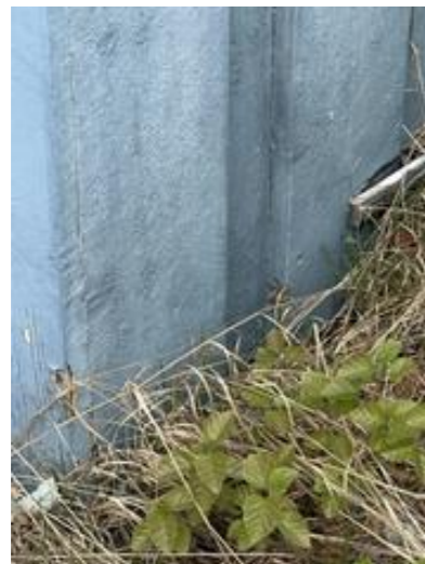
Kledning er nær/under bakken.
