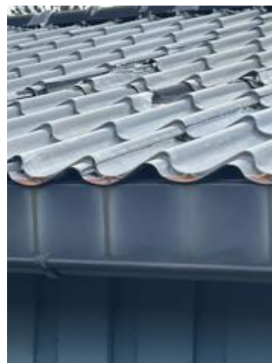
Rust på takplater.
