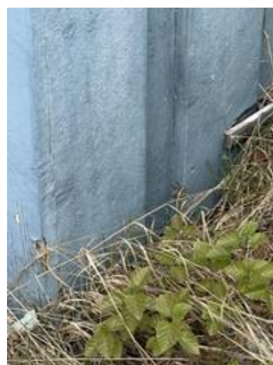
Kledning er nær/under bakken.
