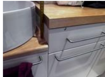
Servantskap står ca. 11,5 cm lavere enn naboskapet.
