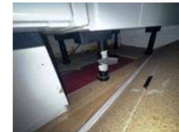
Løse frontsokler og skader på lamineringen.
