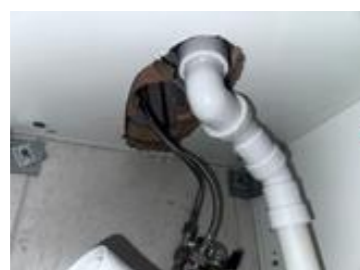
Avløp under servant på bad.
