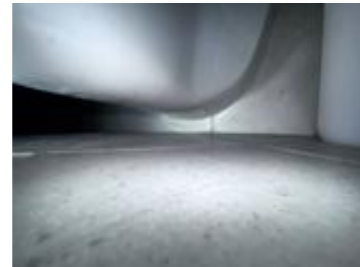
Ingen spalte under innebygget systerne.
