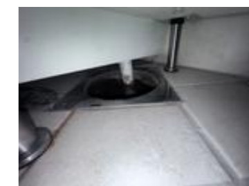
Sluk under servantskap. (avstand ca. 5-6 cm)
