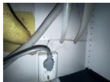
Pex rør uten sikkerhetsrør (rør i rør)
