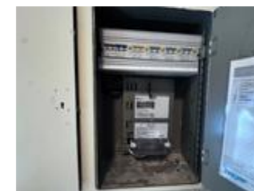
Sikringsskap med automatsikringer.
