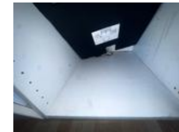
Fukt/svelleskader på bunnplate under servantskap.
