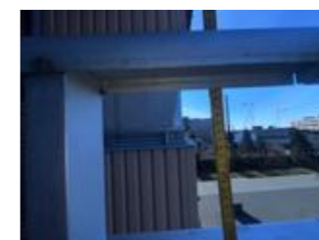
Åpning mellom rekkverk/håndløper ca. 19 cm
