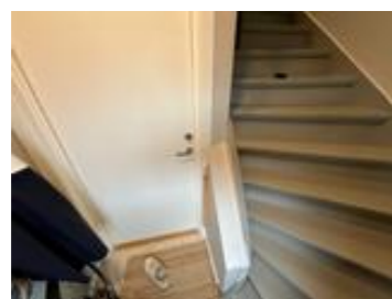
Manglende rekkverk. Se mer info under HMS-punkt.
