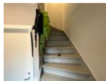
Manglende håndløpere. Se mer info under HMS-punkt.
