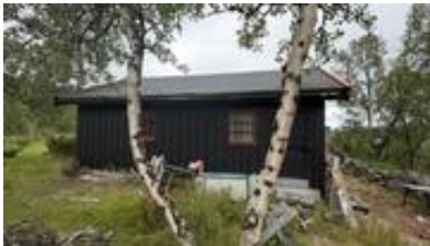
Takrenne på baksiden av bygget mangler nedløp.
