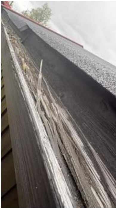
Bildet viser slitasje og deforming av takrenne.
