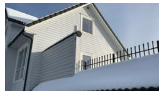
Deler av rekkverk på terrasse er for lavt.
