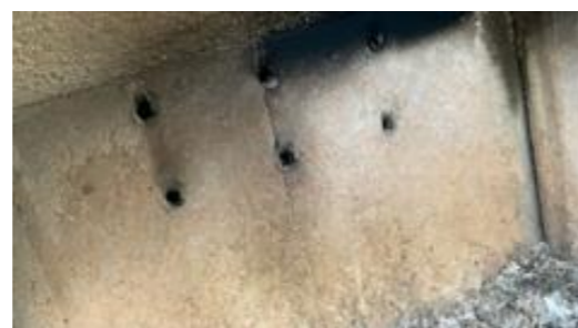
Riss/sprekk i ildfast stein i ovn.
