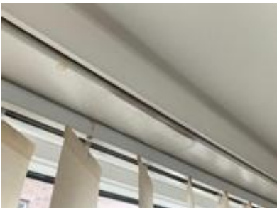
Fuktskader i toppforing til vindu i stue.
