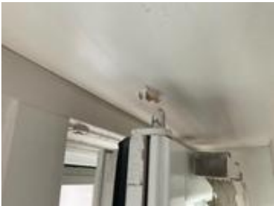
Skade i toppforing til vindu i soverom.
