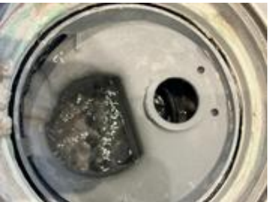
Manglende komponent på vannlås i sluk (område med hull til høyre).
