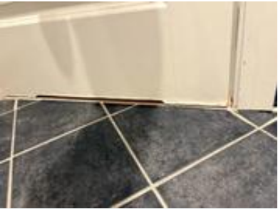
Slitasje på nedre del av dør.
