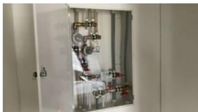
Vannfordelerskap på vegg i soverommet.
