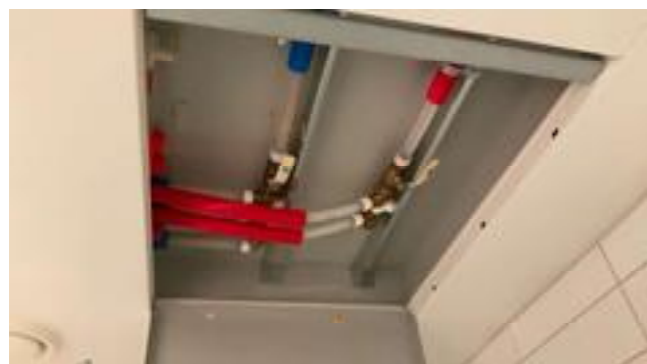
Vannfordelerskap i tak på bad med stengekraner på vann.
