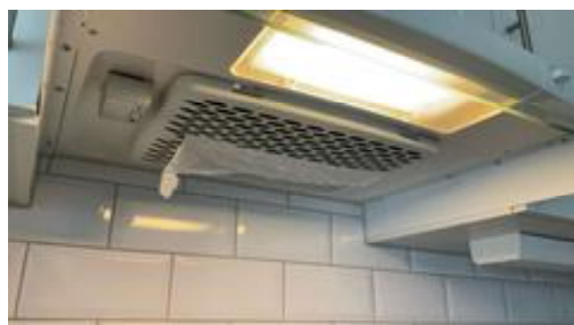
Ventilator funksjonstestet med papir.
