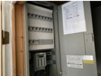
Sikringsskapet i hoveddelen
