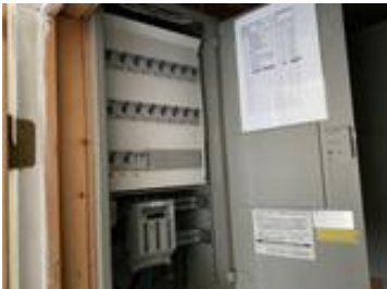
Sikringsskapet i hoveddelen
