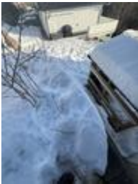
Støttemur med manglende sikring
