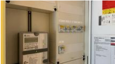
Sikringskap med automatsikringer.
