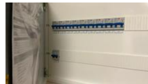
Sikringskap med automatsikringer.
